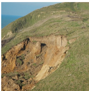
Glissement de terrain – Equihen -Plage
