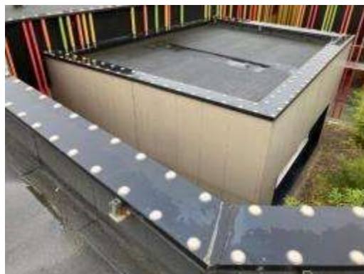
Figure 5 - Coupelles de gel répulsif en place sur la toiture du multi-accueil Arc-en-Ciel (source : interne)
